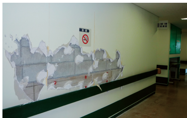
【震災時の病棟廊下】
